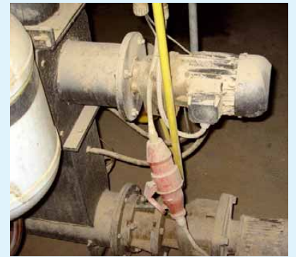
1 Beeinträchtigung der elektrischen Anlagen und Betriebsmittel durch Staub
