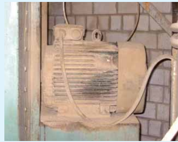
4 unzureichend befestigte Leitungen an einem Antriebsmotor
