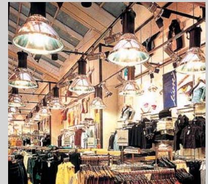
2 Einsatz von Kompakt-Leuchtstofflampen in Tiefstrahlerleuchten zur Grundbeleuchtung
