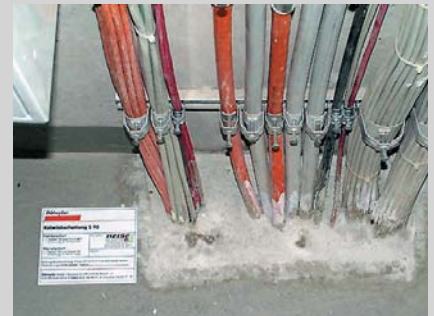
4 c) Neben der Kabelschottung ist ein Kennzeichnungsschild anzubringen. Es enthält Angaben zu Bauart und Verwendbar-keitsnachweis sowie den Namen des Herstellers und das Datum.
