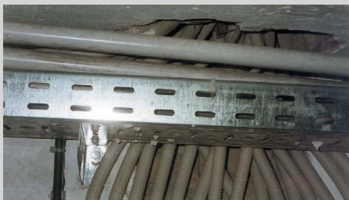
⑨ Schlechte Koordination: Eine Schottung ist kaum mehr möglich. Damit alle Komponenten am Schott in einer Hand liegen, sollte die Brandschutzschottung im Leistungsverzeichnis des Gewerks Elektro enthalten sein.
