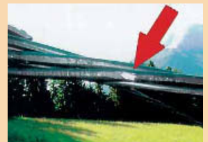
2 Beschädigte Isolierung des Leiterseils
