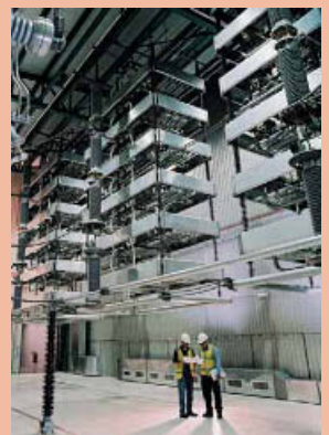
1 Stromrichter-Ventiltürme der HGÜ-Verbindung zwischen Nordirland und Schottland mittels direkt lichtgezündeten Thyristoren und integriertem Überspannungsschutz
