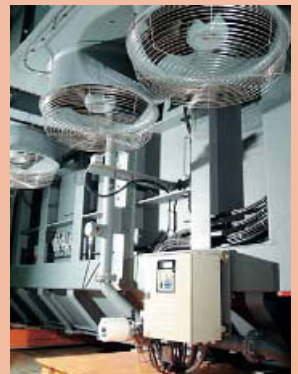
2 Phasenschieber-Transformator mit TEC-Schrank
