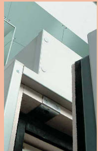
9 Komplettes Brandschutzsystem, bestehend aus Kanälen, Zwischenstücken und Verteilern Fa. Hager
