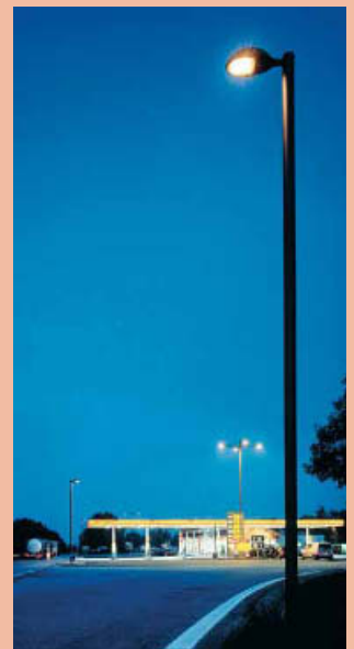
28 Straßenleuchte Milewide Fa. Philips-AEG
