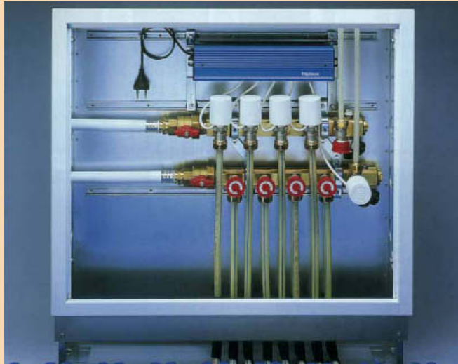
④ Heizkreisverteiler mit elektrischen Stellventilen
