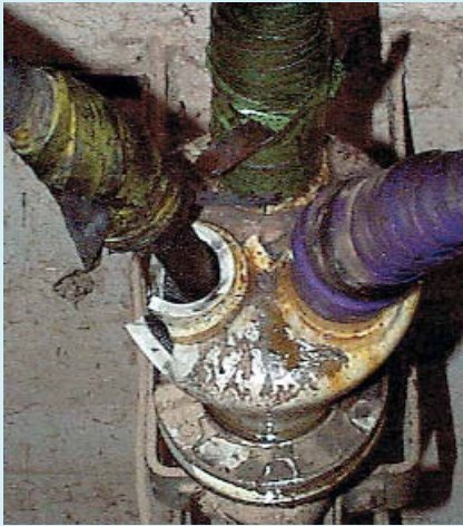
② Durch eingedrungene Feuchtigkeit explodierter Endverschluss
