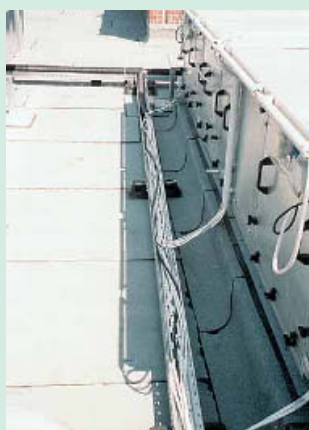
③ NYM-Leitungen unge-schützt im Freien
