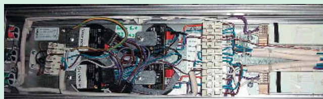
2 Steuerung der Lampen über LCN-Module
