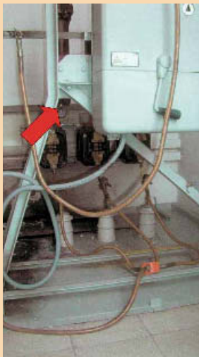
❶ Schaltzelle, die ohne Auftrag geöffnet wurde (E&K-Vorrichtung wurde zur Unfalluntersuchung eingebaut)
