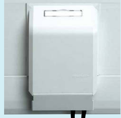
❸ Die LWL-Anschlusseinheit ist vor Schmutz, Staub und mechanischen Beschädigungen geschützt
