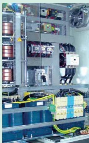
1 Spannungsstellgerät zum Senken der Energiekosten in Beleuchtungsanlagen Foto: Fa. Schuntermann
