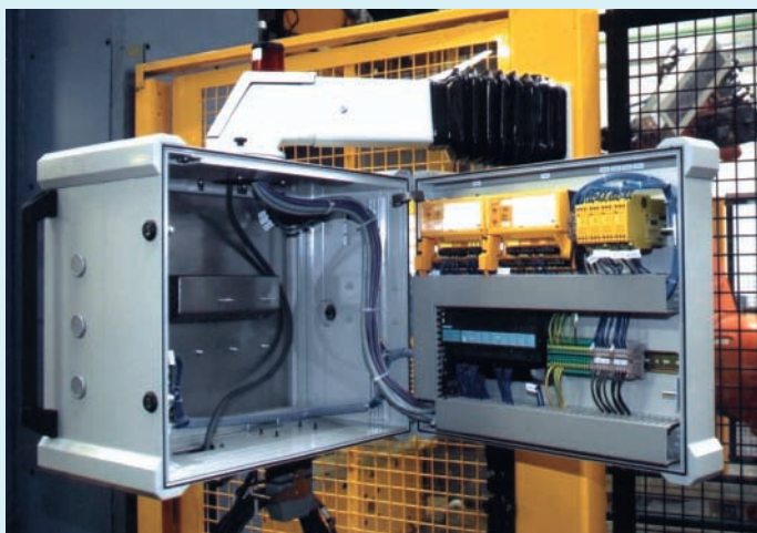
❸ Ein-/Ausgabe-Module des sicheren Bussystems
