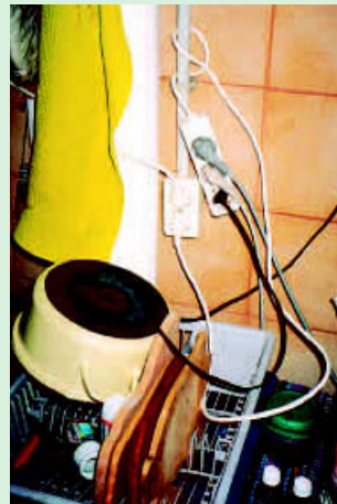
8 Anschluss der Großgeräte in der Küche
