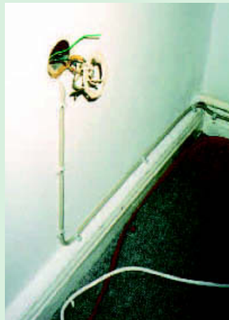
4 Steckdose als Verteilzentrum für mehrere Räume
