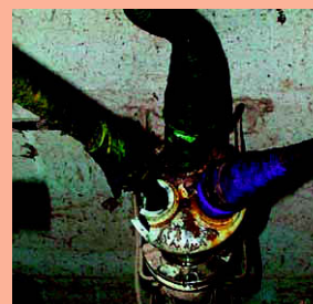
2 Durch eingedrungene Feuchtigkeit explodierter Endverschluss
