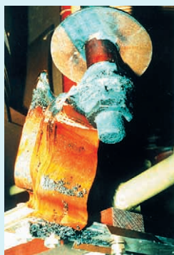
5 Schaden an einem 110/10-kV-Transformator durch Überhitzung
