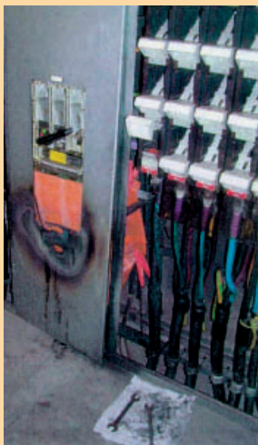
❶ Durch das unsachgemäße Arbeiten in der Nähe unter Spannung stehender Teile wurde ein Lichtbogen verursacht
