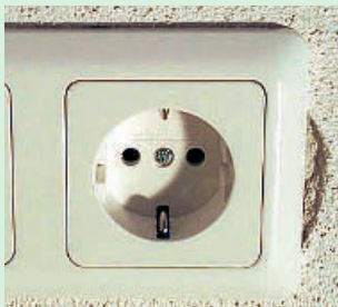
1 Seitliche Putzausbrüche durch unsachgemäßes Ausschlagen des UP-Deckels
