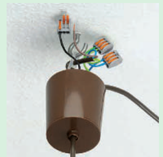
③ Deckendose mit Übergang von eindrähtig auf feindrähtig
