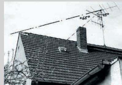
2 Umständliche Ermittlung des Einbauwinkels von einem Antennenstandrohr nach einem Blitzschlag in den Giebel mit Brandfolge
