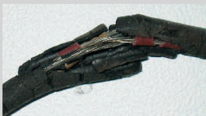
⑦ Beschädigte Anschlussleitung (unvollkommener Kurzschluss)
