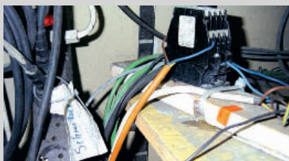
⑥ Unzulässige Montage elektrischer Betriebsmittel auf brennbarem Material
