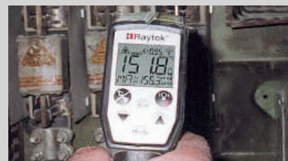
⑧ Unzulässig hohe Temperatur an einem NH-Sicherungselement aufgrund schlechter Kontaktgabe
