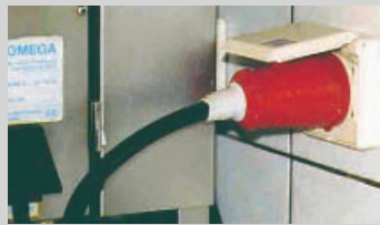
➋ In den Arbeitsbereich hineinragende Zuleitungen sind riskant.
