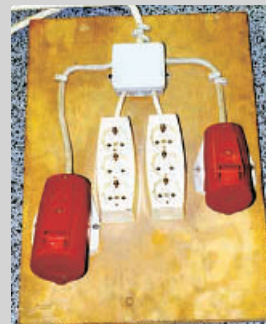
➎ Solche „Brettinstallationen“ sind gefährlich und auch nicht zulässig.
