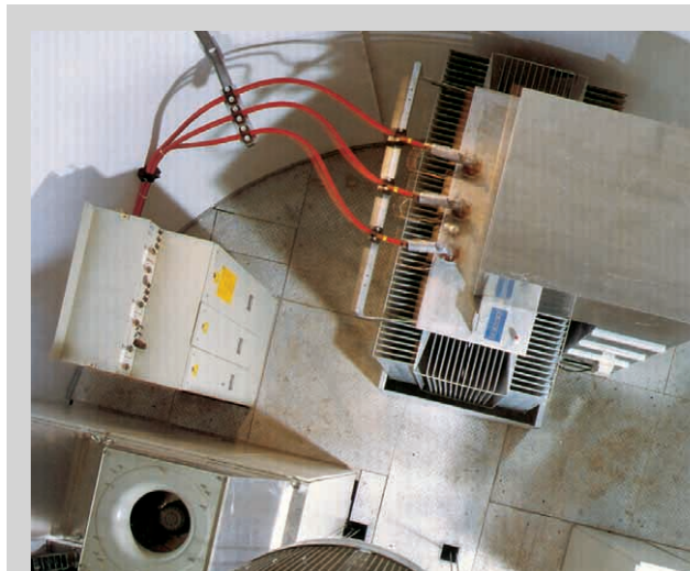
1 Draufsicht auf den im Turmfuß integrierten Transformator mit den Kühlrippen, roten Mittelspannungskabeln und SF 6 -Schaltanlage.
