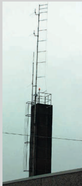
③ Sendeturm mit isolierter Fangeinrichtung und definiertem Näherungsabstand
