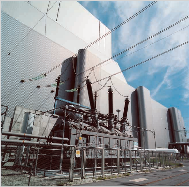
❶ Neukauf oder Ertüchtigung – eine Frage, die bei der angespannten Finanzlage in den EVU und bei den relativ hohen Investitionen enorm wichtig geworden ist. Bis zu 10 Millionen Euro kann ein Leistungstransformator kosten. Foto: Siemens PTD
