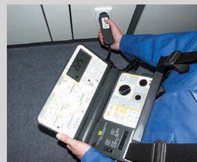
① Die Wiederholungsprüfung von elektrischen Anlagen schützt Sachwerte und vor allem Menschen, die von diesen Anlagen umgeben sind
