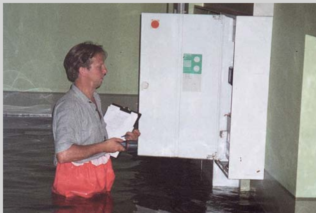
② Elektromeister Frank Höhne vor dem Zählerschrank einer hochwassergeschädigten Anlage
