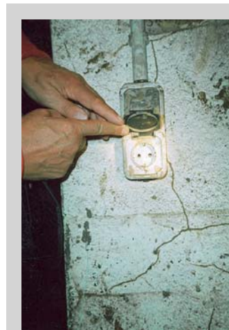
6 Schmutzablagerungen auf Installationsgeräten
