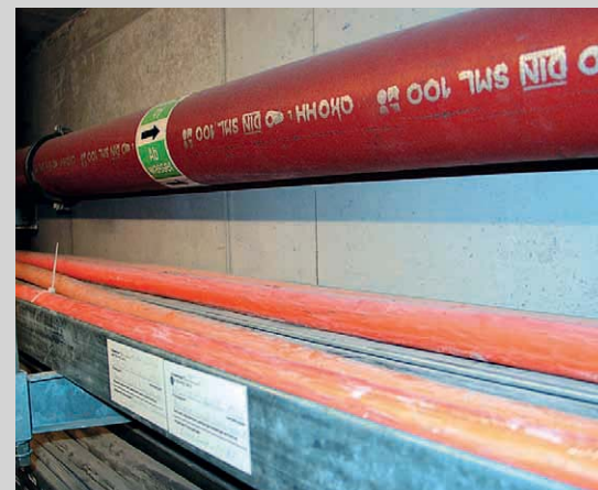
3 Über einer Leitungstrasse mit Funktionserhalt dürfen keine Installationen verlegt sein, die im Brandfall auf die Trasse fallen können.
