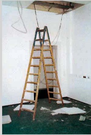
❶ Der Monteur wollte eine Kabelklemme aufstecken, hatte aber vorher nicht freigeschaltet
