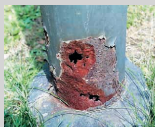
① Schwachstelle Erdeintrittsbereich Fotos: ZWP
