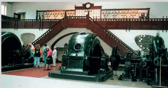
③ Zwei erhaltene Maschinensätze vor der alten Leitwarte
