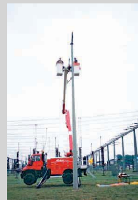
2 AuS an MS-Freileitungen der e-on Bayern
