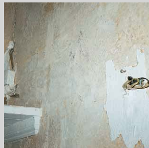
③ Defekte Stegleitung auf dem Hängboden; berührbare Leitungsdarmen
