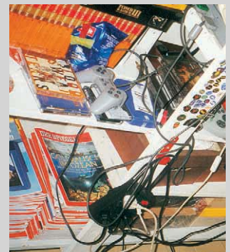
④ Eigeninstallation des Mieters, um seine etwa 12 Elektrogeräte über die eine Steckdose des Raums versorgen zu können
