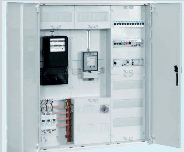
13 Zähler- und Verteilerschrank DISPO PLUS Fa. Geyer
