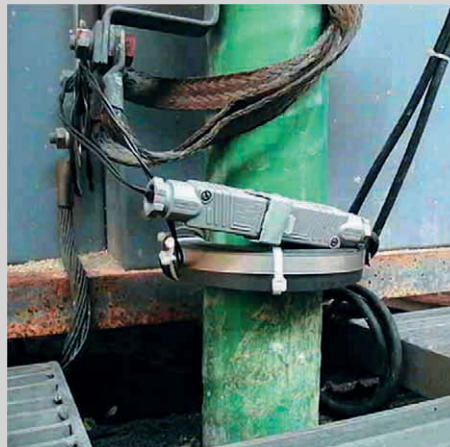
❶ Beispiel einer induktiven Ankoppelung (CDI): Die Kabel sind samt Kabelschirm durch das CDI geführt
