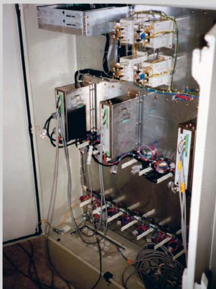
③ Basiseinheit einer Kopfstation mit Schutzbeschaltungen und Steuerkabelmodem zur Leitstelle
