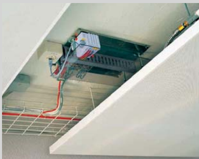
5 In der Kühldecke installiert: der Controller zur Steuerung von Raumtemperatur, Raumfeuchte, Kühldeckenventil, Licht u.a.
