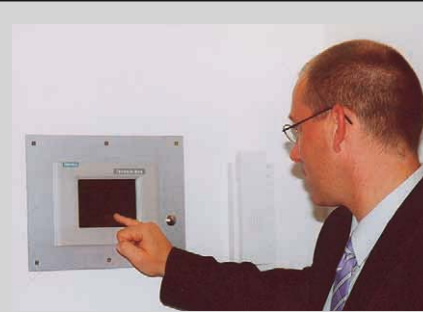
1 Die Mieter können über eine Technik-Box mit Touch-Panel in Verbindung mit dem TwinBus-EIB-Türsprechsystem Informationen über Wohnung und Wohnumfeld abrufen
