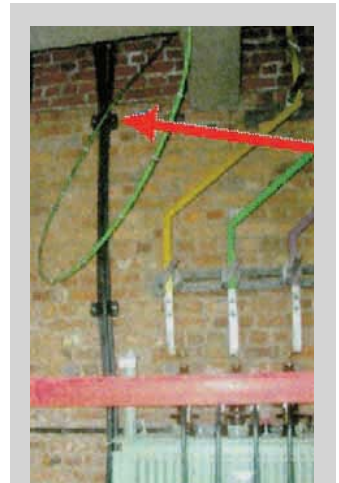
② In Übereifer begann der Monteur die Schelle des 20-kV-Kabels zu lösen, ohne auf die Freigabe zu warten
