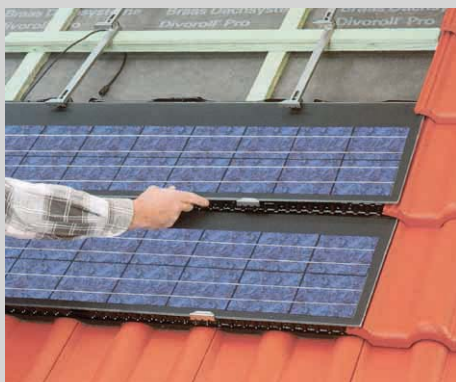
5 PV-Module übernehmen die Funktion der Dachhaut
