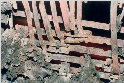
❶ Auswirkungen eines Lichtbogens innerhalb einer isolierstoffgekapelten Verteileranlage der Schutzart IP 55 durch Überschreiten vorgegebener Grenztemperaturen
