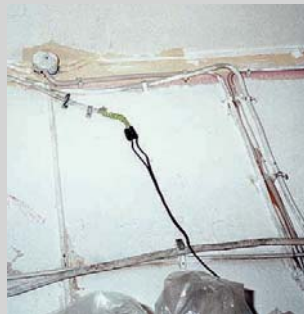
② Vielfach erweiterte Kreuz- und Quer-Installation der Wohnung
