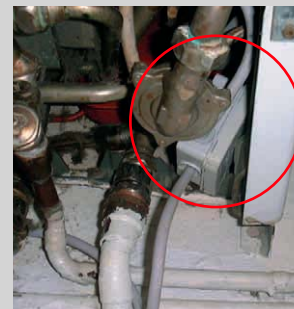
4 Abzweigdose in der Gas-therme, gegenüber der ursprünglichen Anordnung weitgehend herausgezogen, ebenso wie die vier in die Dose führenden, nicht befestigten NYM-Leitungen
