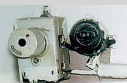
3 Sicherungselement mit Einschraub-LS-Schalter, Zuleitung NGA 4 x (?) mm 2 , Ausschalter im (PEN ?)-Leiter, Abgang mit Rohrdraht
