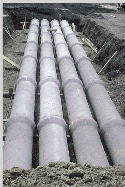
3 Erdreich-Wärmetauscher aus Betonrohren zur Vorerwärmung von Frischluft (bereits in 2 m Tiefe ist die Temperatur des Erdreichs mit etwa 10 °C (im Sommer und Winter) nahezu konstant)
