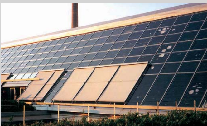
⑤ Seit vergangenem Winter zeigen sich Flecke auf dem Solardach des BMWi, die auf Fertigungsfehlern beruhen. Noch in diesem Jahr wird Lieferant Pilkington alle PV-Gläser an der 9 m hohen und 180 m langen Glasfassade auswechseln.
