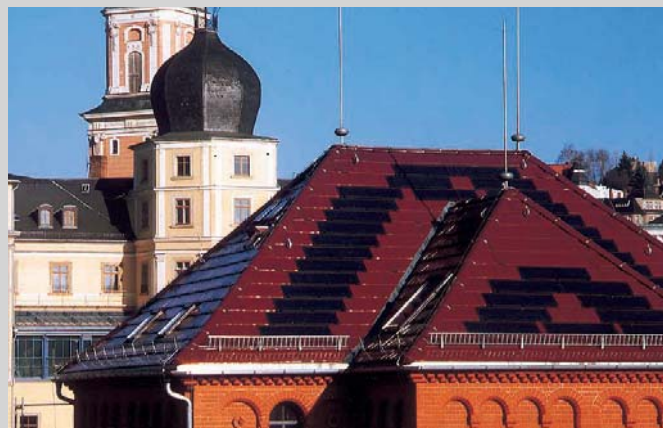
3 Im denkmalgeschützten „Roten Haus“ in Greiz (Thüringen) hat eine 2,6 kW p -PV-Anlage, gestaltet aus Modulen des Terra-Platta-Solarsystems, die Stromerzeugung übernommen.
