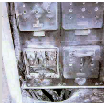
2 Ausgebrannte 20-kV-Station nach dem Kurzschluss
