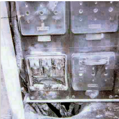
2 Ausgebrannte 20-kV-Station nach dem Kurzschluss
