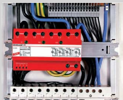
5 Blitz- und Überspannungsschutz mit Kombi-Ableiter
