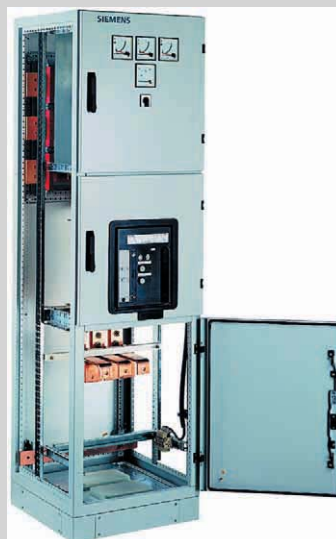
① TSK-Einspeisefeld mit Messung
