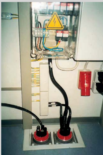
14 Elektroanschluss in einer Basisstation – Stromeinspeisung, Überspannungsschutz, Hauff-Durchführung, Erdung und Potentialausgleich
