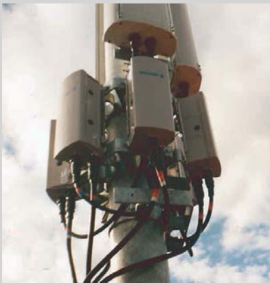
10 Zwischenverstärker am Antennenmast (TMA-Ring) – die minimalen Biege-
