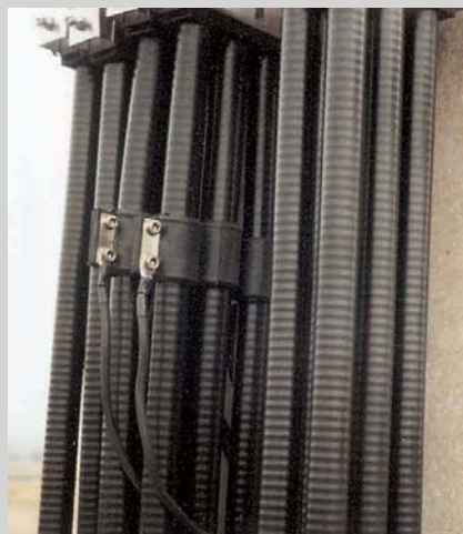
16 Wellmantelkabel mit Erdungsgarnitur am Antennenmast
