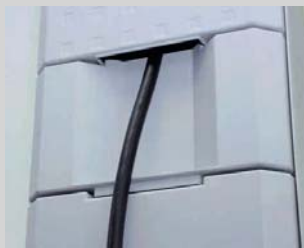
10 Anschluss säule zur Aufstellung im Freien Foto: Jean Müller
